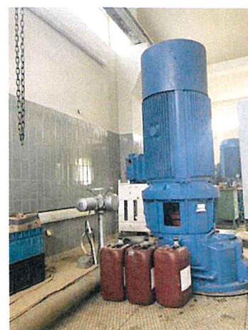
Im Inneren des Schöpfwerkes sind die Pumpen zu finden. Insgesamt sind es vier.
