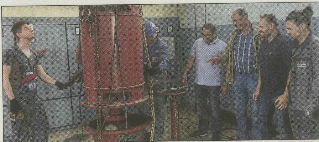
Thomas Henrichmann, stellvertretender Geschäftsführer des Mittelweserverbandes, und Verbandsvorsteher Gerhard Winter (Mitte) begutachten den Ausbau der Hochleistungspumpe im Intscheder Schöpfwerk.
